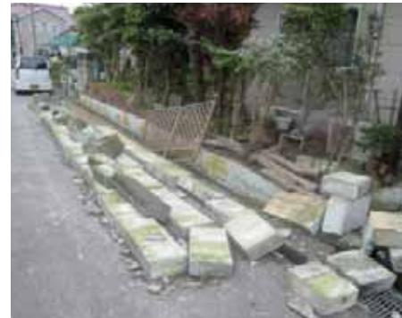
倒壊した石塀
