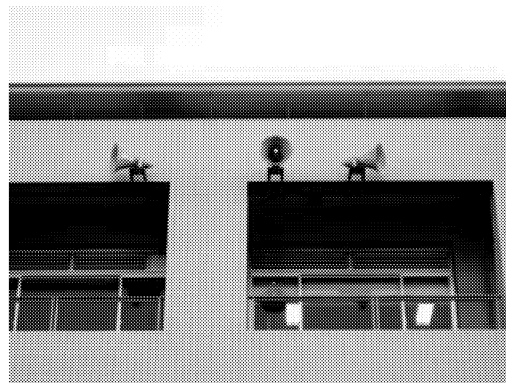
防災無線屋外スピーカー
