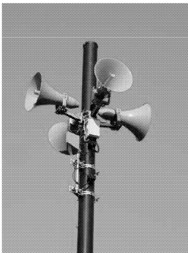
防災無線屋外スピーカー
