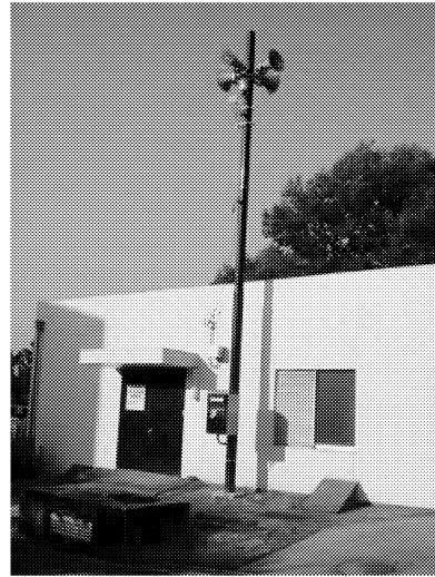
半固定型無線局全景
