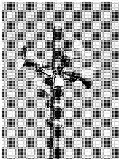
防災無線屋外スピーカー
