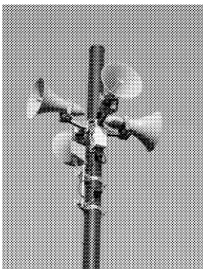
防災無線屋外スピーカー
