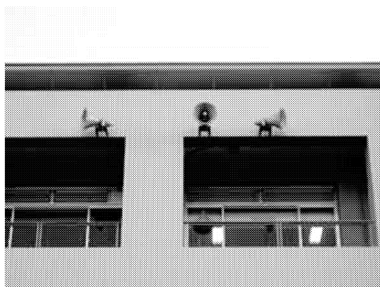
防災無線屋外スピーカー
