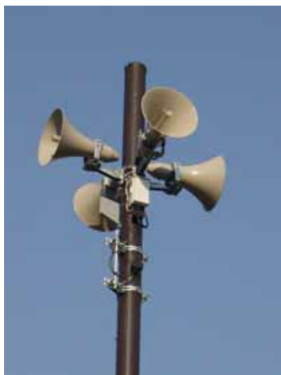
防災無線屋外スピーカー
