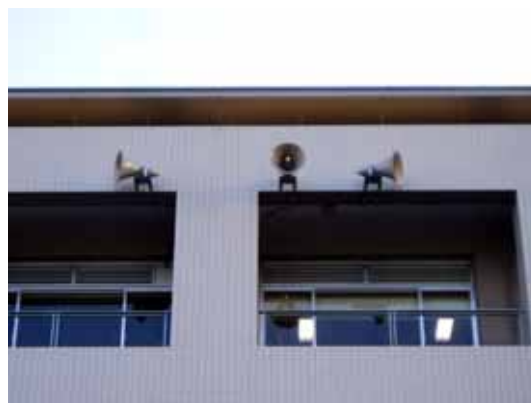
防災無線屋外スピーカー
