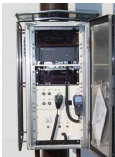
半固定型無線機収納状況
