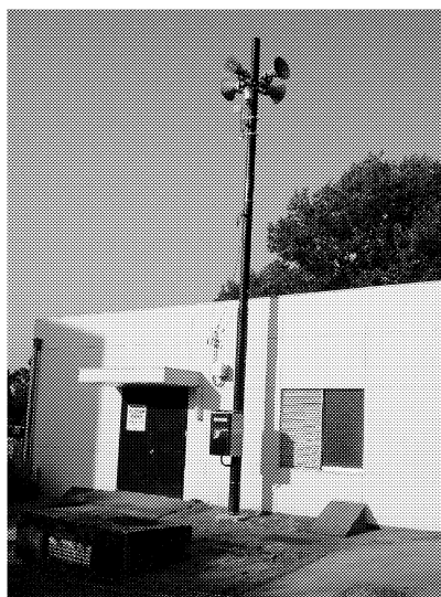
半固定型無線局全景
