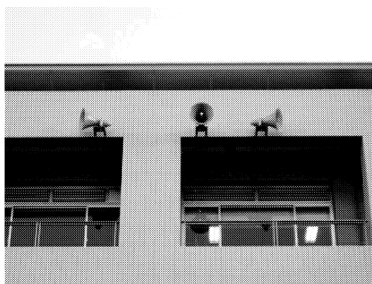
防災無線屋外スピーカー
